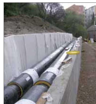
Nedaleko Palmovky bylo třeba potrubí uložit do paty náspu podél železniční trati. K tomuto účelu se budoval speciální betonový kanál.
