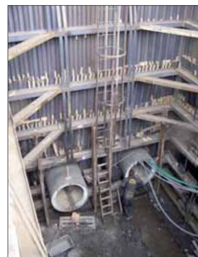
Až čtyřicet pět metrů dlouhé protlaky pod silnicemi pro nový horkovod se razily v hloubce okolo 7 m. Do otvoru se nasazovaly trubky o průměru 120 cm.
